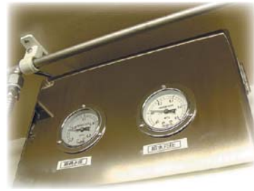
元圧・濾過圧水圧計
